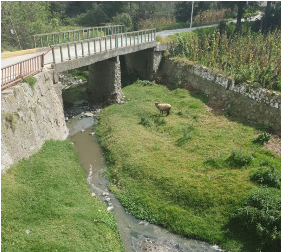
Fuente: Descargas de aguas servidas./GBCG
